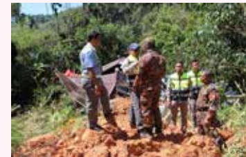
Siasatan tapak kejadian tanah runtuh di Kampung Teras, Batu Kurau, Perak
