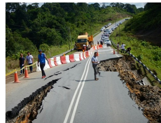
Pemeriksaan Tapak Bencana Geologi: Bukit Song, Jalan Miri Bintulu
