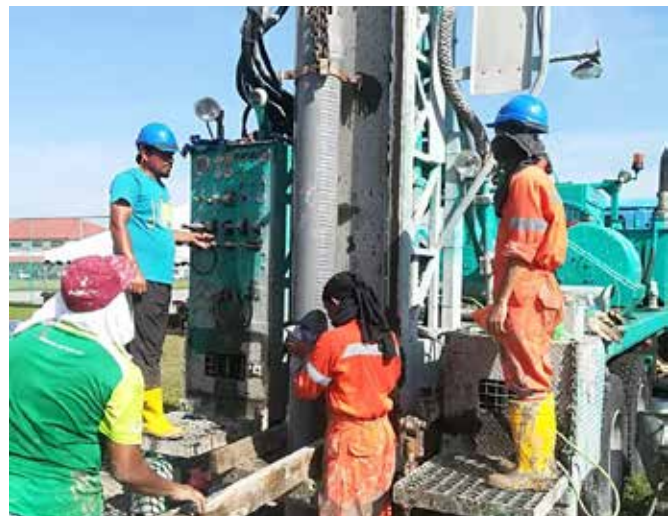
Kerja-kerja pembinaan telaga pengeluaran sedalam 100 m oleh Bahagian Perkhidmatan Teknikal di Sekolah Menengah Sains Bagan Datuk (SABDA). Well construction work with 100 m depth by the Technical Services Division at Sekolah Menengah Sains Bagan Datuk (SABDA).
