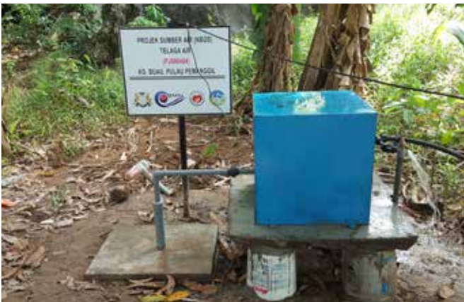
Telaga pengeluaran bagi kegunaan domestik di Kg. Bauu, Pulau Pemanggil Johor. Production well for domestic purpose at Kg. Bauu, Pulau Pemanggil, Johor.
