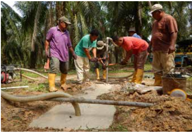
Pengejetan telaga eksplorasi di Chini, Pekan, Pahang Jetting of exploration well at Chini, Pekan, Pahang
