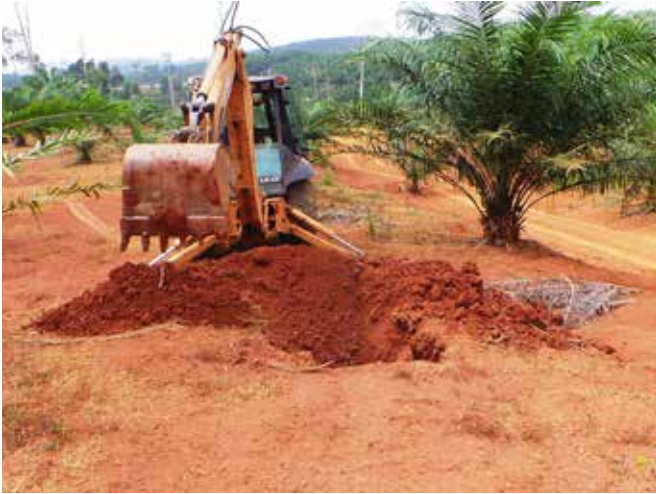
Pengorekan lelubang dengan menggunakan jengkaut di Felcra Bt. Segumpal Maran, Pahang Pit excavations using a backhoe in Felcra Bt. Segumpal Maran, Pahang
