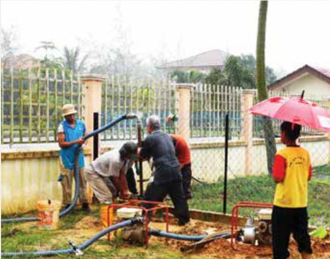
09.01.2015 Pembinaan telaga dengan kaedah pengejetan di UDK Mahligai Well construction by jetting method at UDK Mahligai
