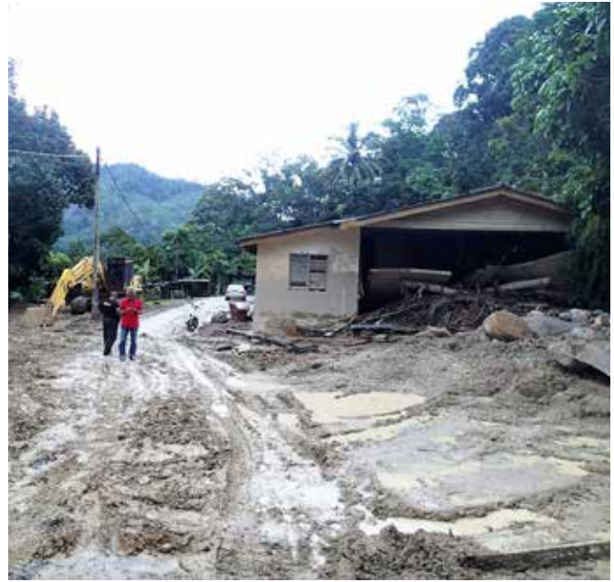
Kuarters Jabatan Perhutanan Lentang, Bentong, Pahang yang mengalami kerosakan teruk akibat limpahan aliran puing dan lumpur pada November 2015
